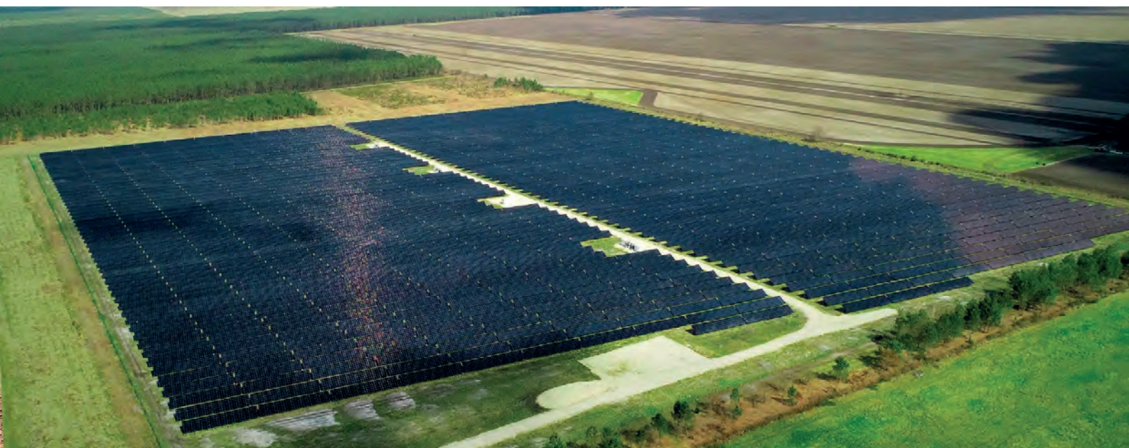
Parc photovoltaïque de Lugos. © neoen.
